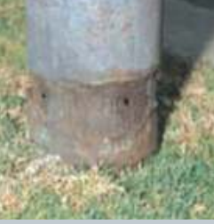
Çelik direkte meydana gelen korozyon Corrosion of steel pole.
